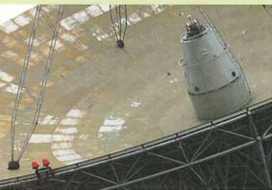
Na de nodige reparaties werkt de schotel weer als vanouds.
